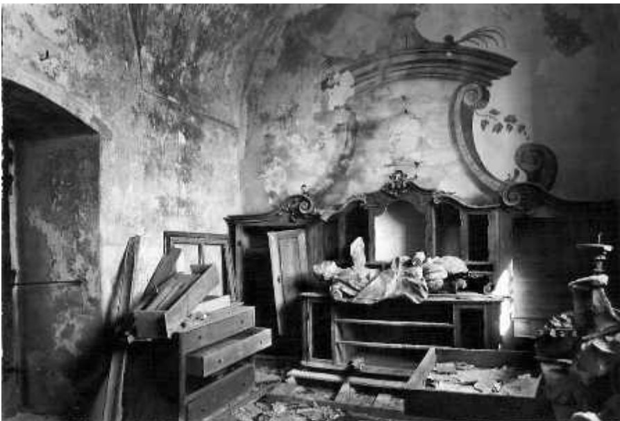
Blick zum Hauptaltar und Haupteingang nach der Herunterstürzung Gewölben in 1957. Zustand zu 1961.
